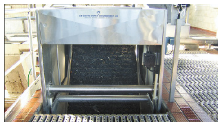
Dieser Rechen filtert die Abfälle aus dem Schmutzwasser.
