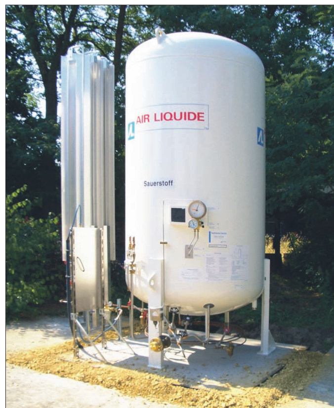
Die Reinsauerstoffdosieranlage für das Projekt.
